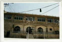
تصویر 1- نمای کلی بنای مسجد جامع شیخ دید از جنوب: ف 13، ن 81
