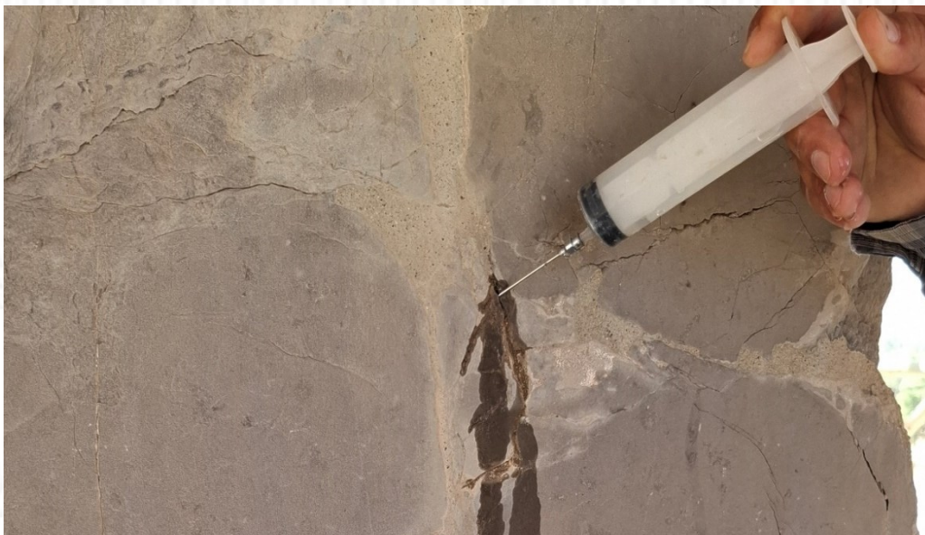
تست ورودی محل تزریق با سرنگ محتوی آب
